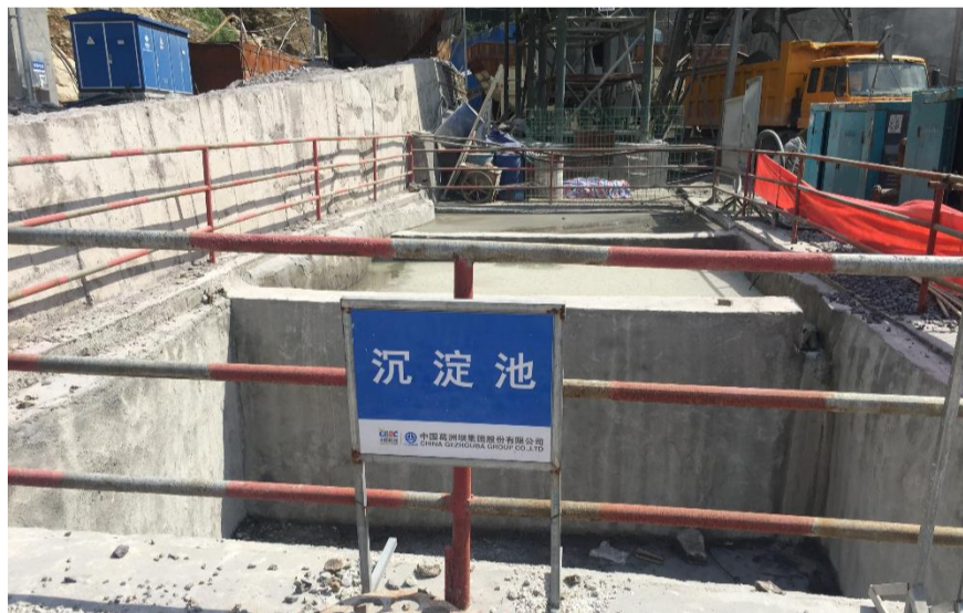
图 5.2-3 3#施工支洞三级沉淀池照片
