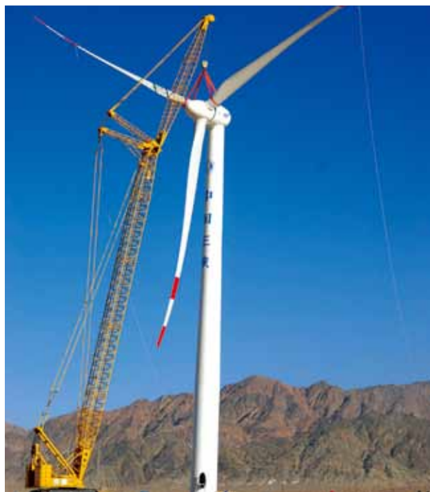
国内首台兆瓦级高海拔试验风机
