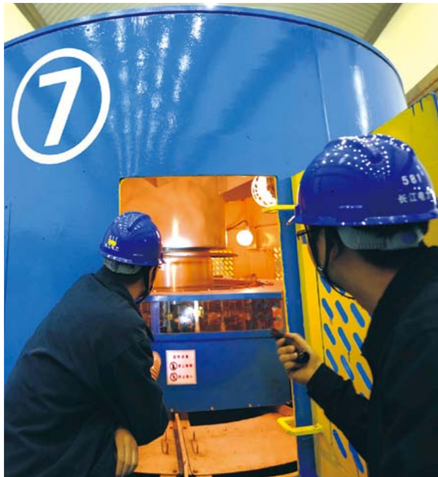
工作人员对机组运行情况进行监测
