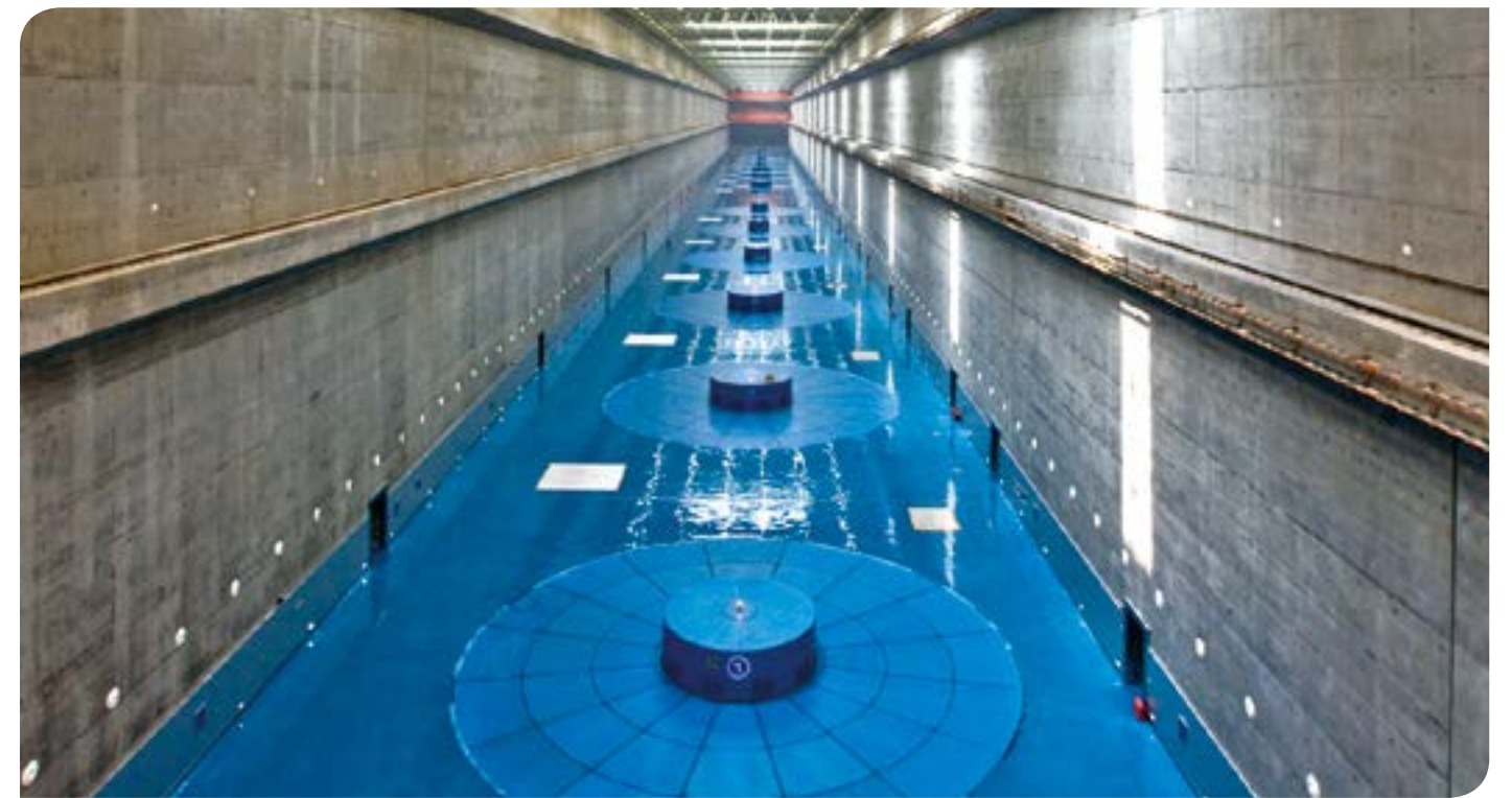
三峡左岸发电厂房
