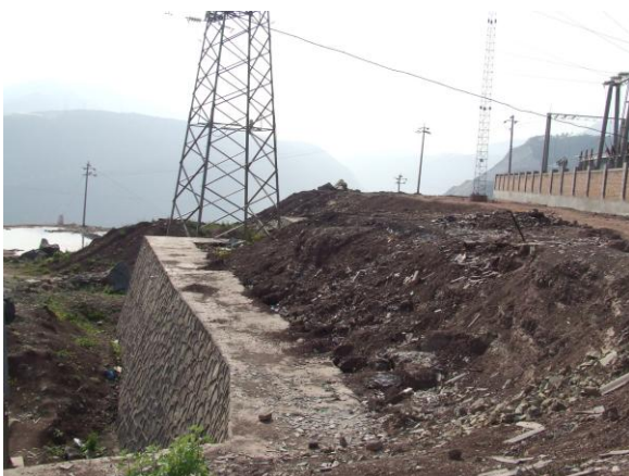
左岸 35kv 变电站
