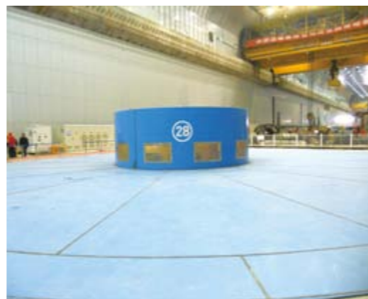
三峡地下电站 28 号机组
