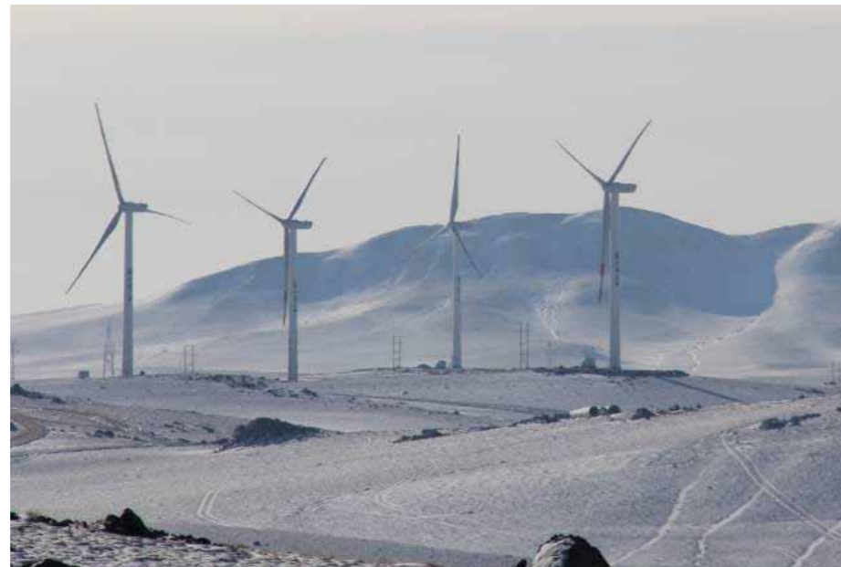
国内单体规模最大的风电项目——内蒙古四子王旗 40 万千瓦项目并网发电
