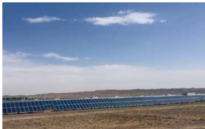
甘肃金昌大寨滩 10 万千瓦沙棘光伏项目
