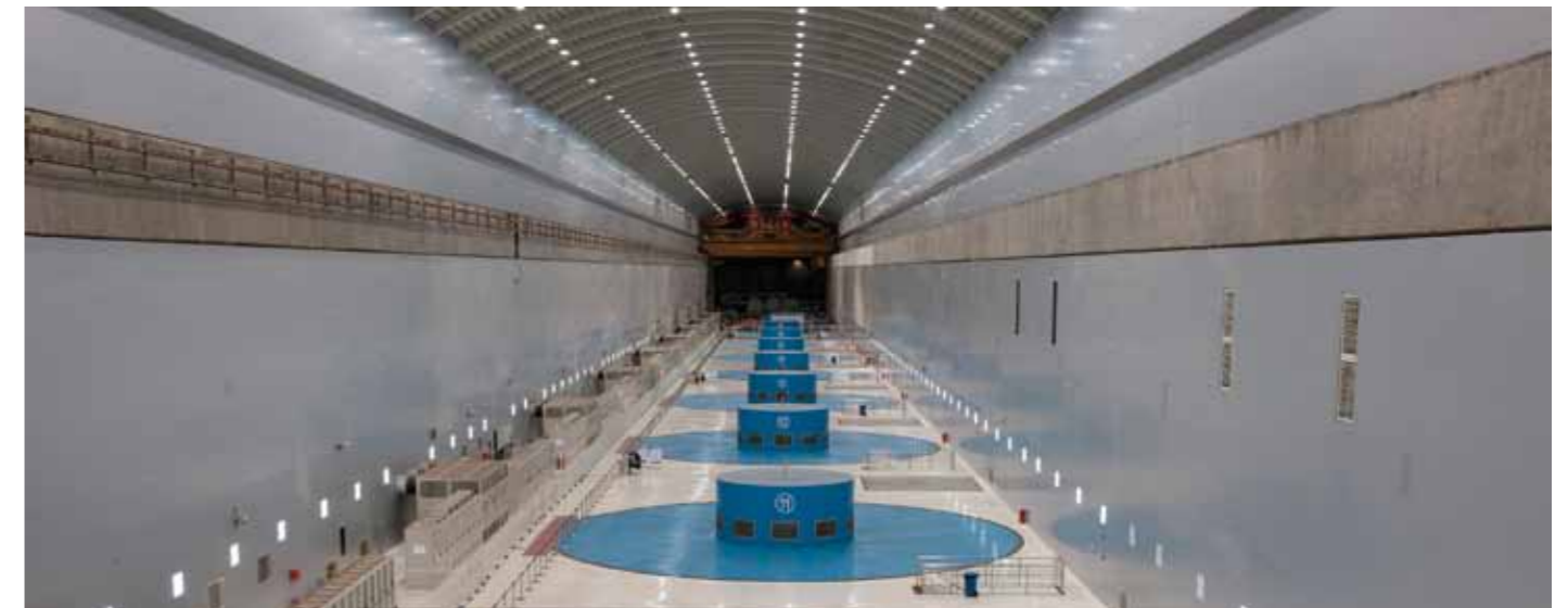
由我国水电设备制造厂商自主研发设计制造的770兆瓦级水轮发电机组在溪洛渡电站平稳运行
