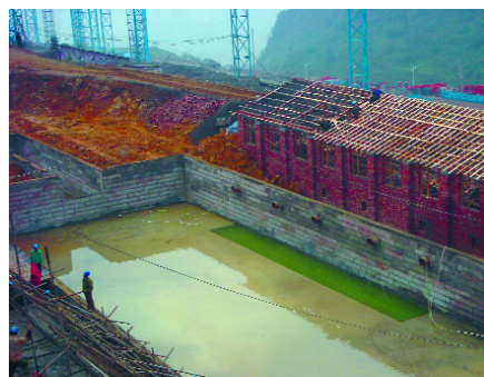
(c)马延坡废水回收车间
