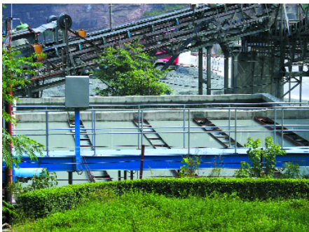
(a)中心场砂石废水处理系统
