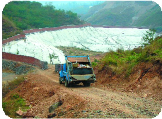
溪洛渡沟垃圾处理场填埋场
