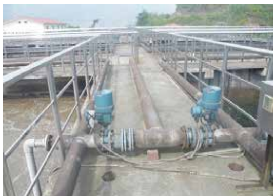
向家坝工程莲花池生活污水处理厂
