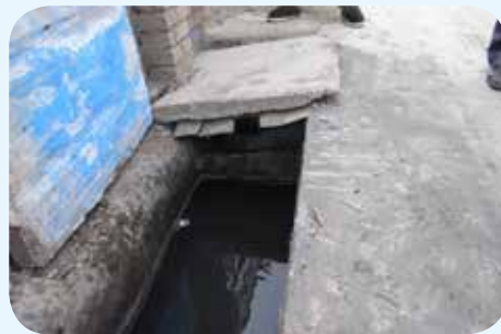
白鹤滩工程六城坝机修厂隔油沉淀池
