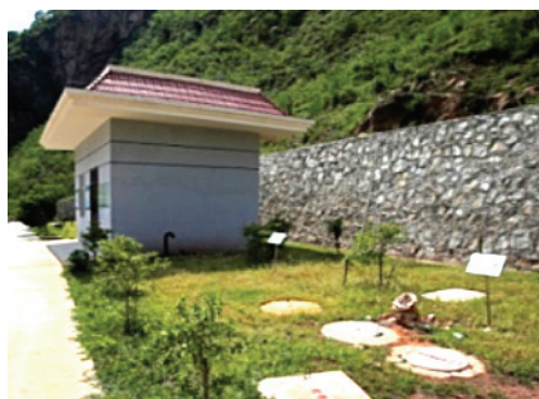
乌东德海子尾巴污水处理
