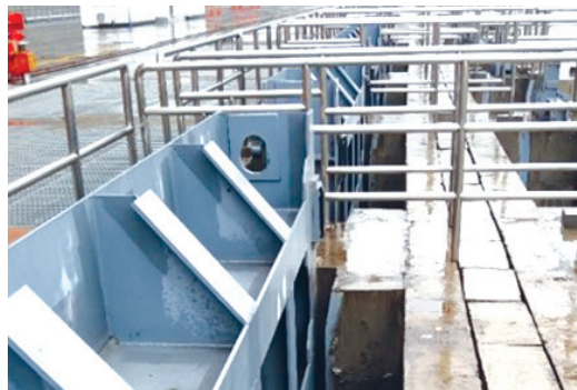
溪洛渡工程分层取水设施
