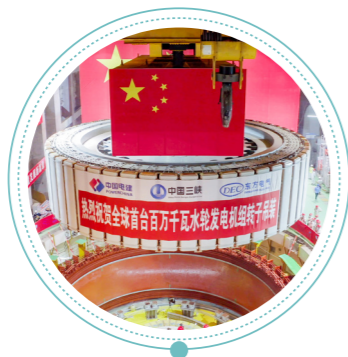
白鹤滩水电站
