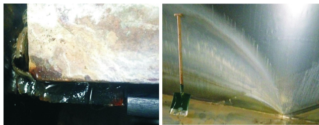
图1 破损水封在侧面钢衬上产生的射水印记图
