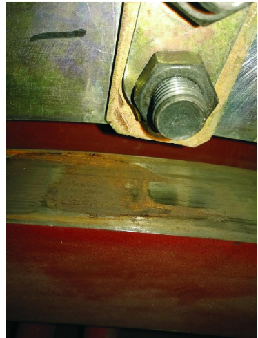
图3 1号机组处理前有锈蚀图
