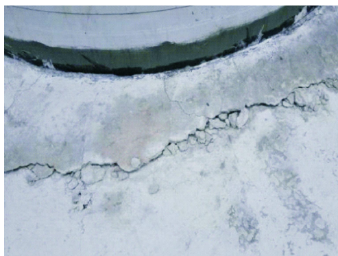
图2 台柱混凝土压碎、裂缝图
