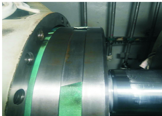
图2 接力器导向环撕裂情况
