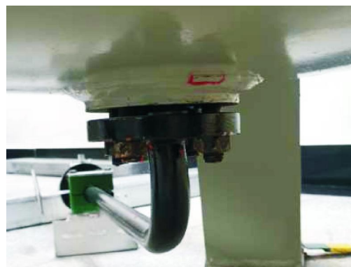
图3 调速器油压装置漏气点图
